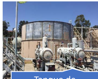
Tanque de almacenamiento
