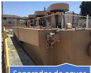
Separador de aguas residuales
