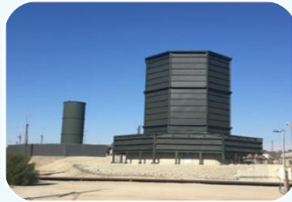
Control de emisiones de quemado en antorcha que no proviene de refinерías
