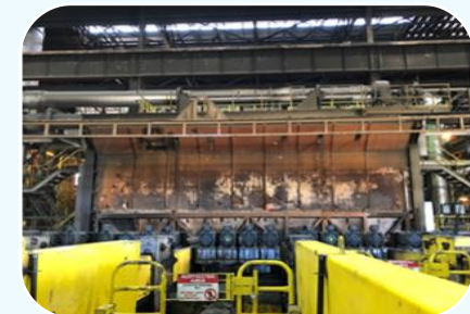
Fuentes varias grandes de combustión
